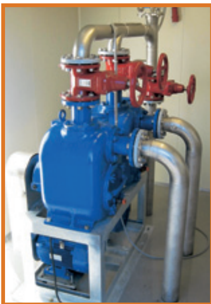
Stazione sollevamento fognatura Sewage lift station
